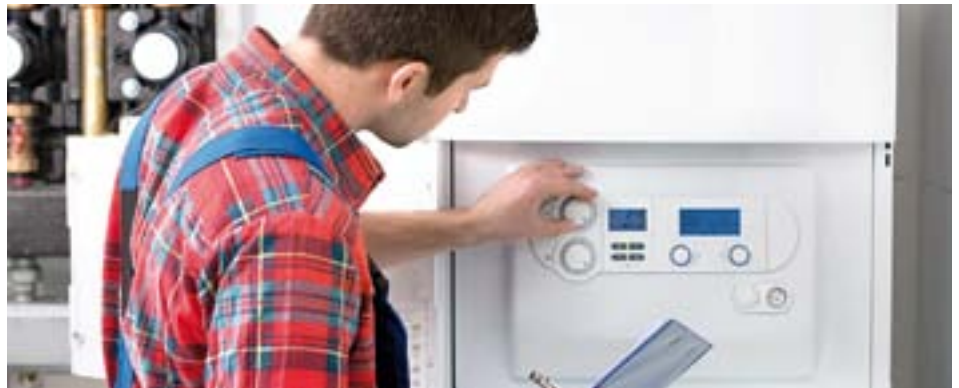
Wärmepumpen sollten regelmäßig vom Fachmann geprüft werden.
